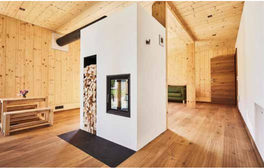
▲ Der Kachelofen im Wohnzimmer beheizt über einen Anschluss an den Pufferspeicher das gesamte Haus
